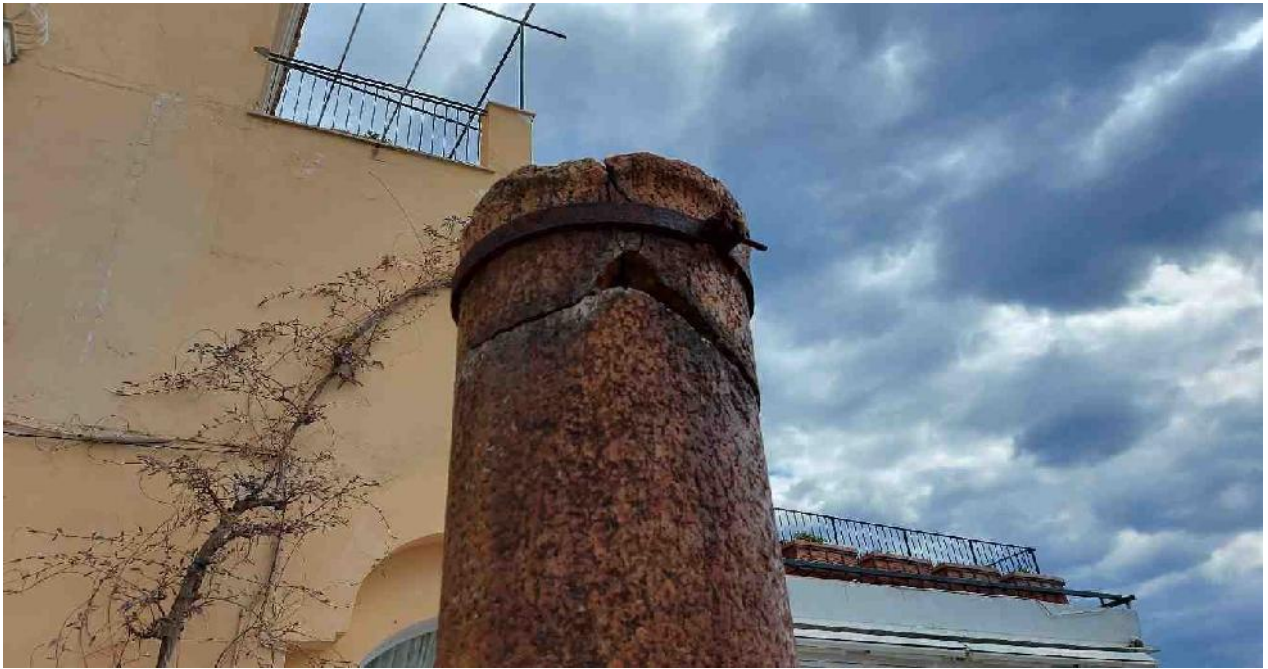
Colonna di granito frammentata e interessata da rilevanti percolazioni di ossidi di ferro
