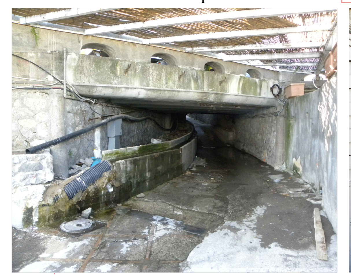
Vasca di c.a. per la raccolta e il trasferimento al depuratore
